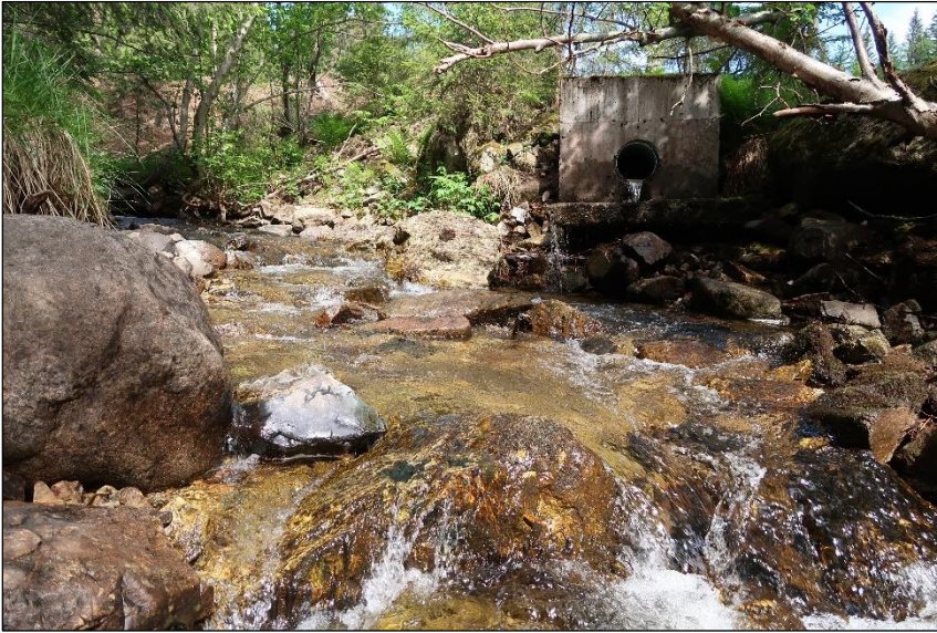
Like nedenfor vannbehandlingsanlegget. Dagens øvre utslippsrør ses øverst th. i bildet.
