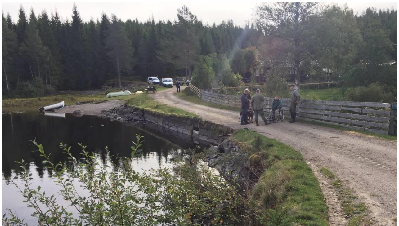
Foto av dammen. 12 meter tørrmur med store steiner i sentrum, sidekanter med jord og steinsatt front og nedstrøms. Vannivå er 1,06 m under veien på befaringsdagen (14.09.2018).
