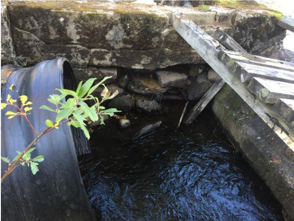
Setninger i sidevegg ved utløpet.
