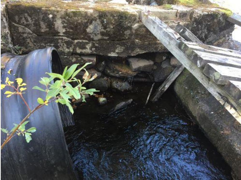
Setninger i sidevegg ved utløp.
