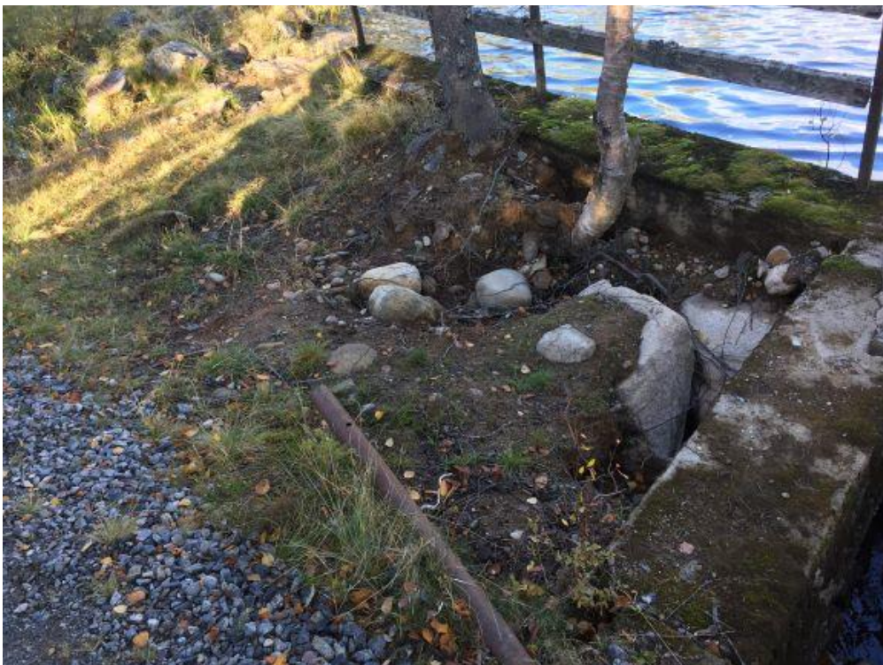
Erosjon ved siden av utløpet.
