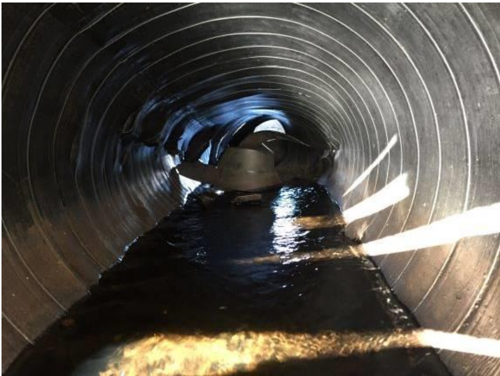
Defekt rør i kulvert under veggen.
