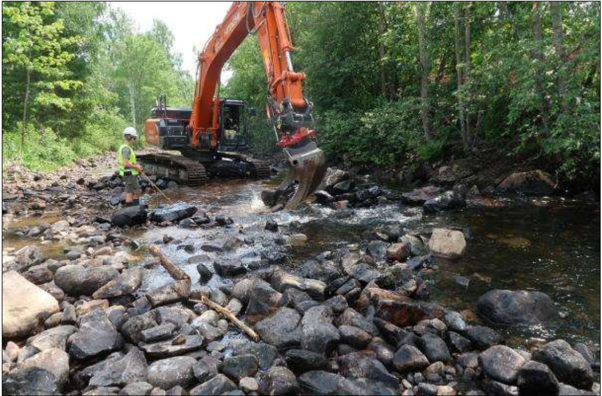
Foto 10. Generell ripping av den harde og «armerte» elvebunnen, og for å fjerne finstoff/akkumulerte sedimenter, og for å få frem steinene i elvebunnen slik at det etableres hulrom for fisken og bunndyrene.
