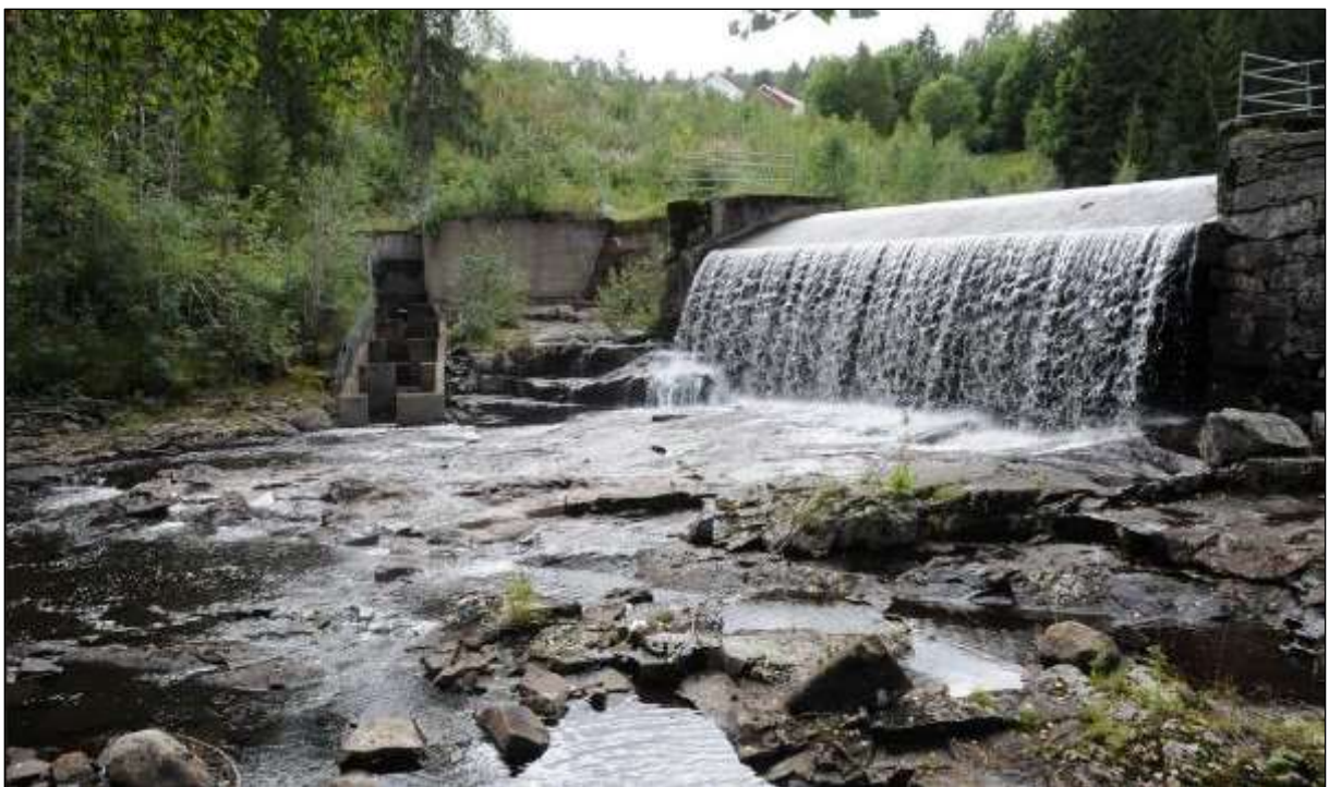
Foto 18. Demning og fisketrapp ved Flaen Mølle, der det pågår arbeid med ekstra miljøtiltak for å bedre nedvandringen. Fisketrappa opp fungerer bra. Blir et eget prosjekt som utføres av en annet tiltakshavere, men må ses i sammenheng med restaureringen av elveløpet, og slik at hele vassdraget miljøforbedres.
