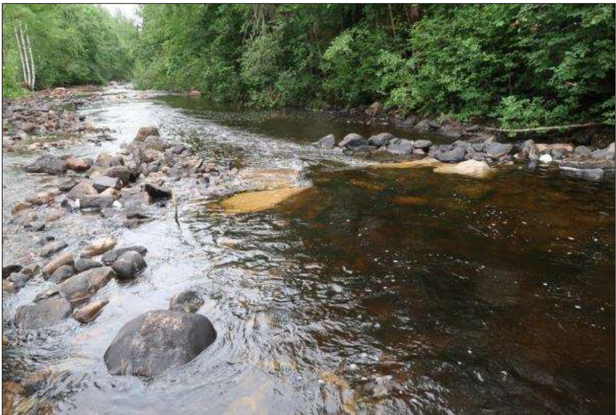
Foto 7. Etablerte naturtypiske brekk og halvterskler. Rader med store steiner øker vannspeilet lokalt, og bedrer forholdene ved lav vannstand. Passet på V-profil i utløpet og liten høydeforskjell for best fiskevandring opp og ned, inkl. for fiskeunger.
