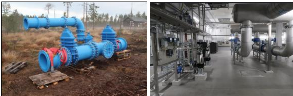
Figur 14. Det er gjort store investeringer i drikkevann, avløpsrensstasjoner og ledningsnett i kommunene i Huvo de siste årene.
